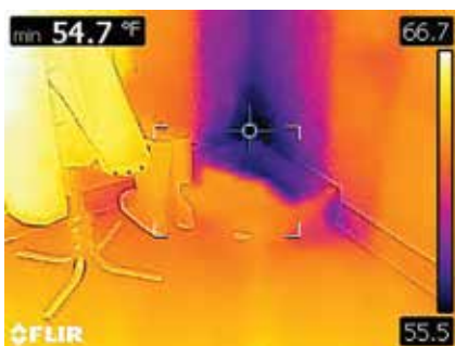
Bereichsfeld mit Cold-Spot-Anzeige macht einströmende Luft sichtbar
